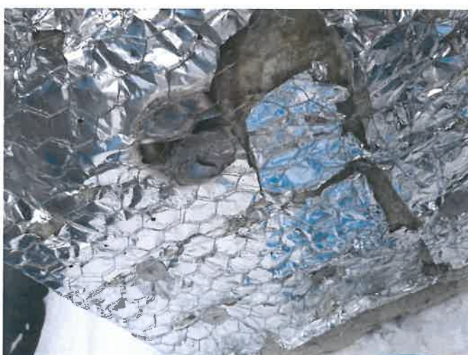
Рис.№ 29. Последствия высокотемпературного воздействия.
